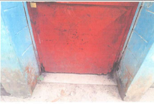
Foto 3: Puera de bodega en mal estado
