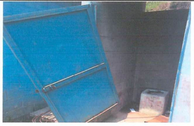
Foto 4: pueta de letrina en mal estado
